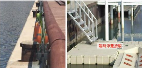
2 可考慮修改繫船柱旁的玻璃欄杆
