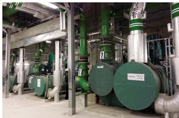
區域供冷系統 – 以冷凍水推動，能夠 節省能源的中央空調系統
